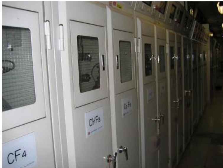
● 고압가스 Cabinet 시설
