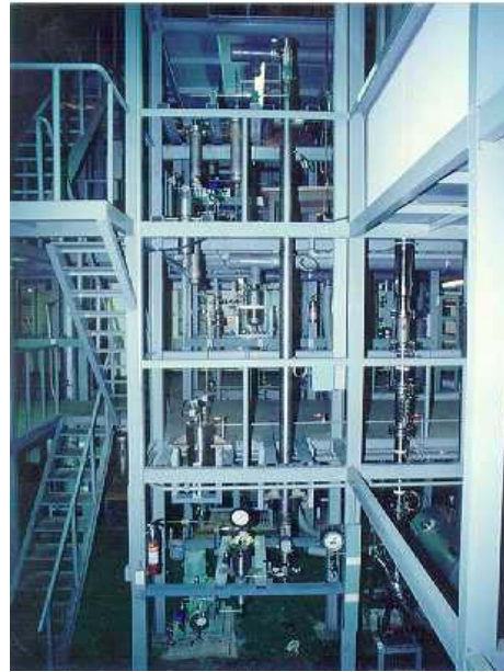
KIST가 보유하고 있는 알콜 농축 초임계 Column Pilot Plant
